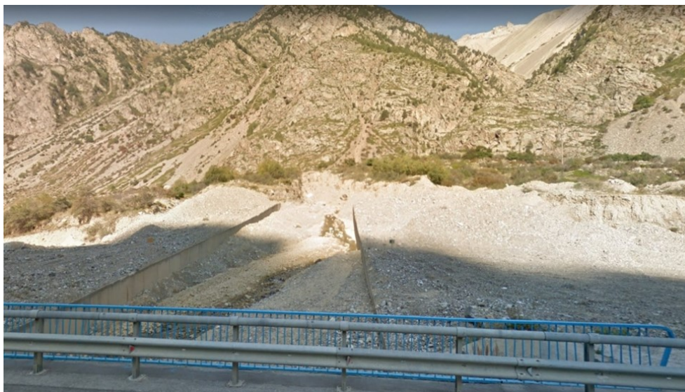
Рисунок 5 – Селепропускной лоток под автодорогой Тырныауз – Терскол и конус селевого выноса на выходе балки Большой Мукулан в долину р. Баксан
