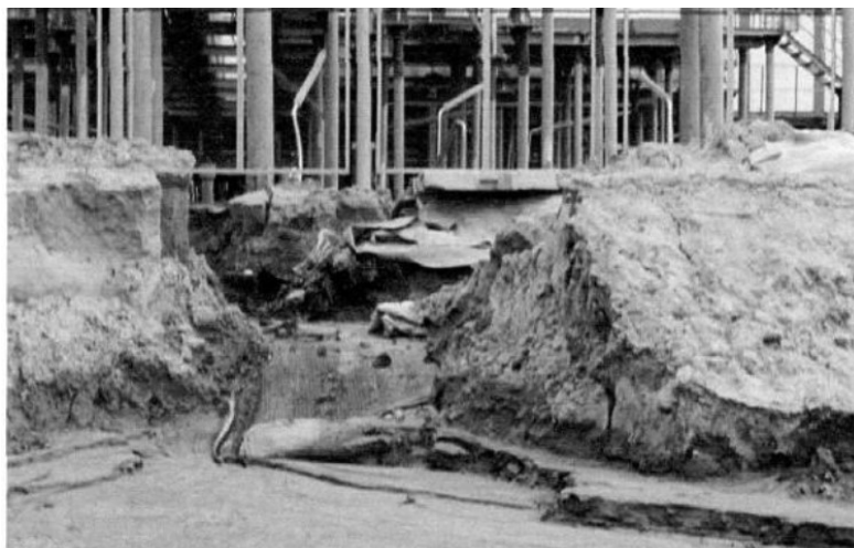
Рисунок 2 – Размыв основания технического сооружения в результате активизации геокриологических процессов (термоэрозия) на территории Бованенковского НГКМ [5]
