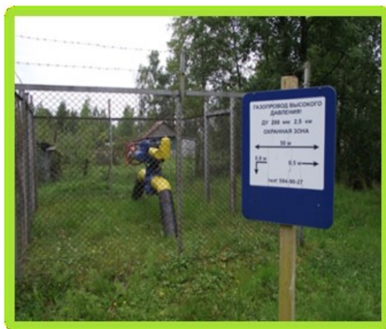
Рисунок 9 – Пример обозначения охранных зон: замерный столб с табличкой охранной зоны «Газопровод высокого давления»
